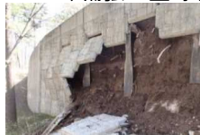
補強土壁の損傷
