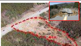
排水不良に起因する法面崩落
