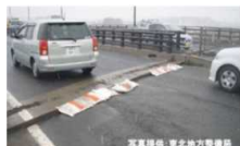
地震時の段差
