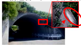
アーチカルバートの損傷
