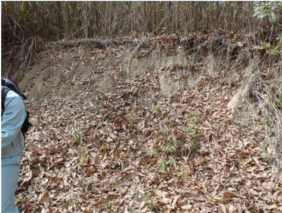
最上部崩壊面（直下の表土厚 20cm）
